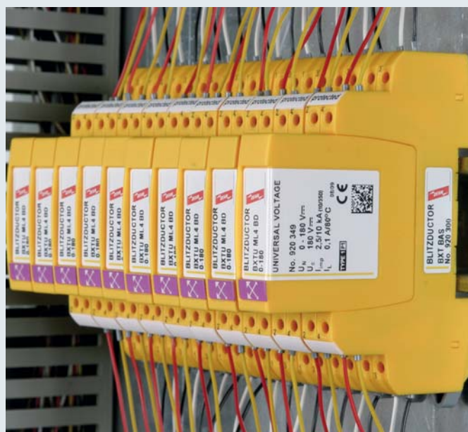
BLITZDUCTOR XTU intégré à l'installation.
