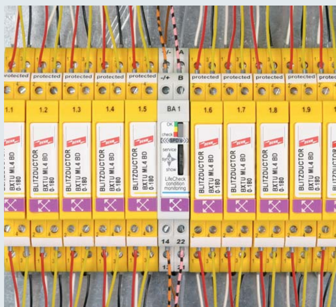
Unité de surveillance d'état DEHNrecord intégrée à l'installation.
