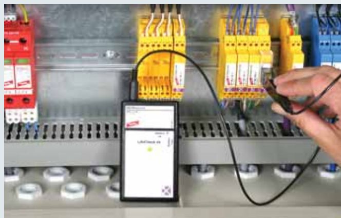
Test d'un module DPS à l'aide de la technologie RFID (LifeCheck)
