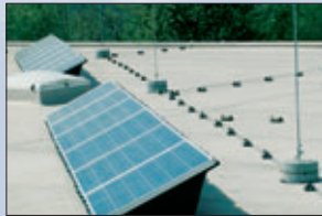
Protection contre la foudre / mise à la terre
