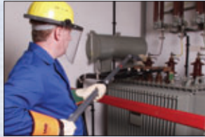
Protection contre les risques électriques
